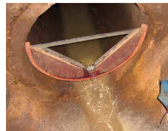
Messwehr im Einsatz
