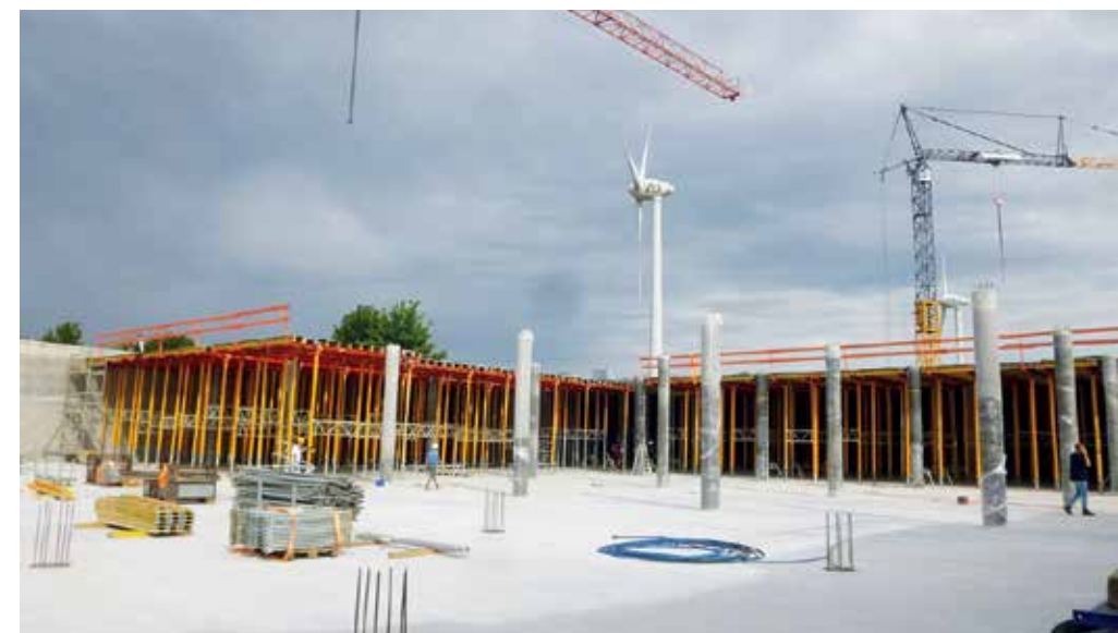
Säulen im Trinkwasserspeicher
